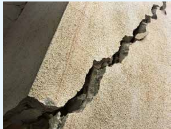
Foto 10. L'Aquila, 2009. Particolare di edificio lesionato dal terremoto del 6 aprile.
