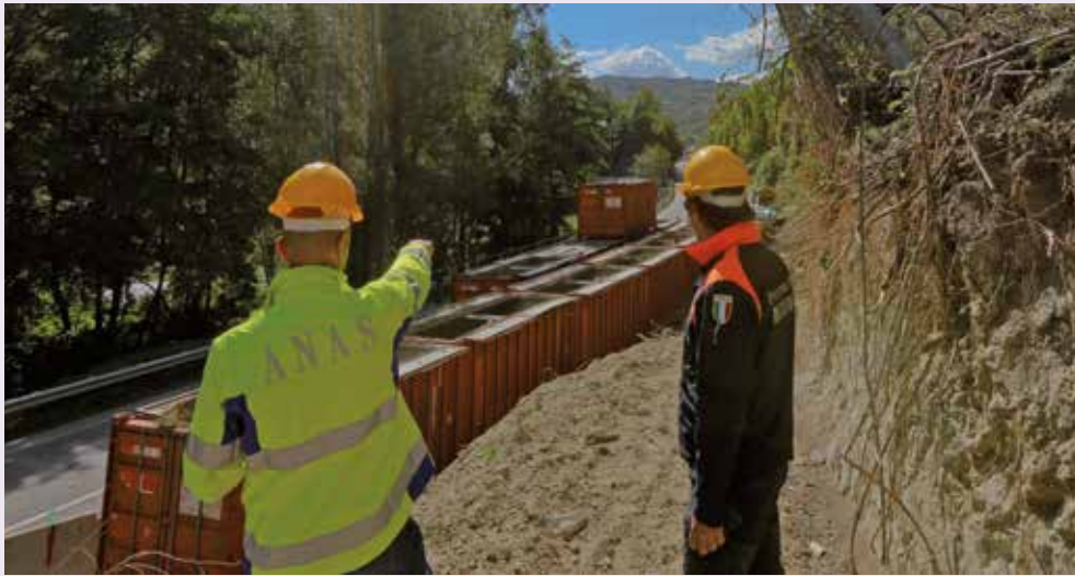
Foto 49. Pescara del Tronto, Ascoli Piceno, 2016. Intervento di ripristino della viabilità dopo i dissesti idrogeologici causati dal terremoto.
